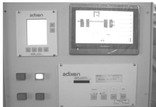
شکل ۱۱- صفحه کنترل سیستم تولید باریکه پوزیترون حرارتی
